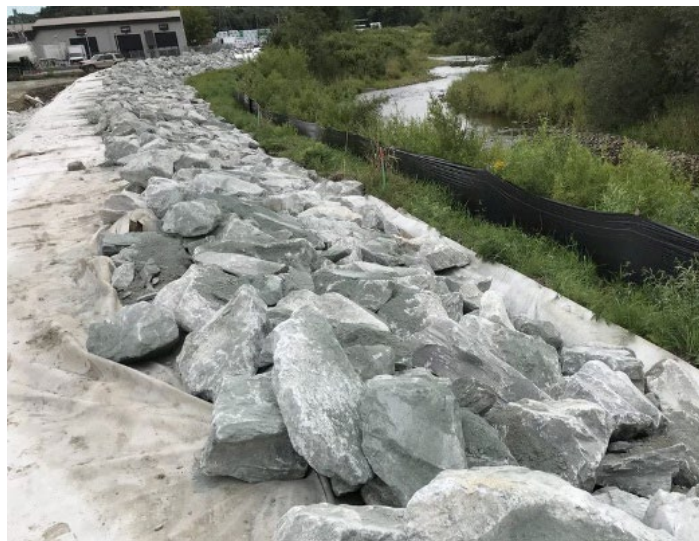
Aménagement d'une digue en bordure d'un ruisseau pour protéger des industries des inondations. Source Ville de Sherbrooke
