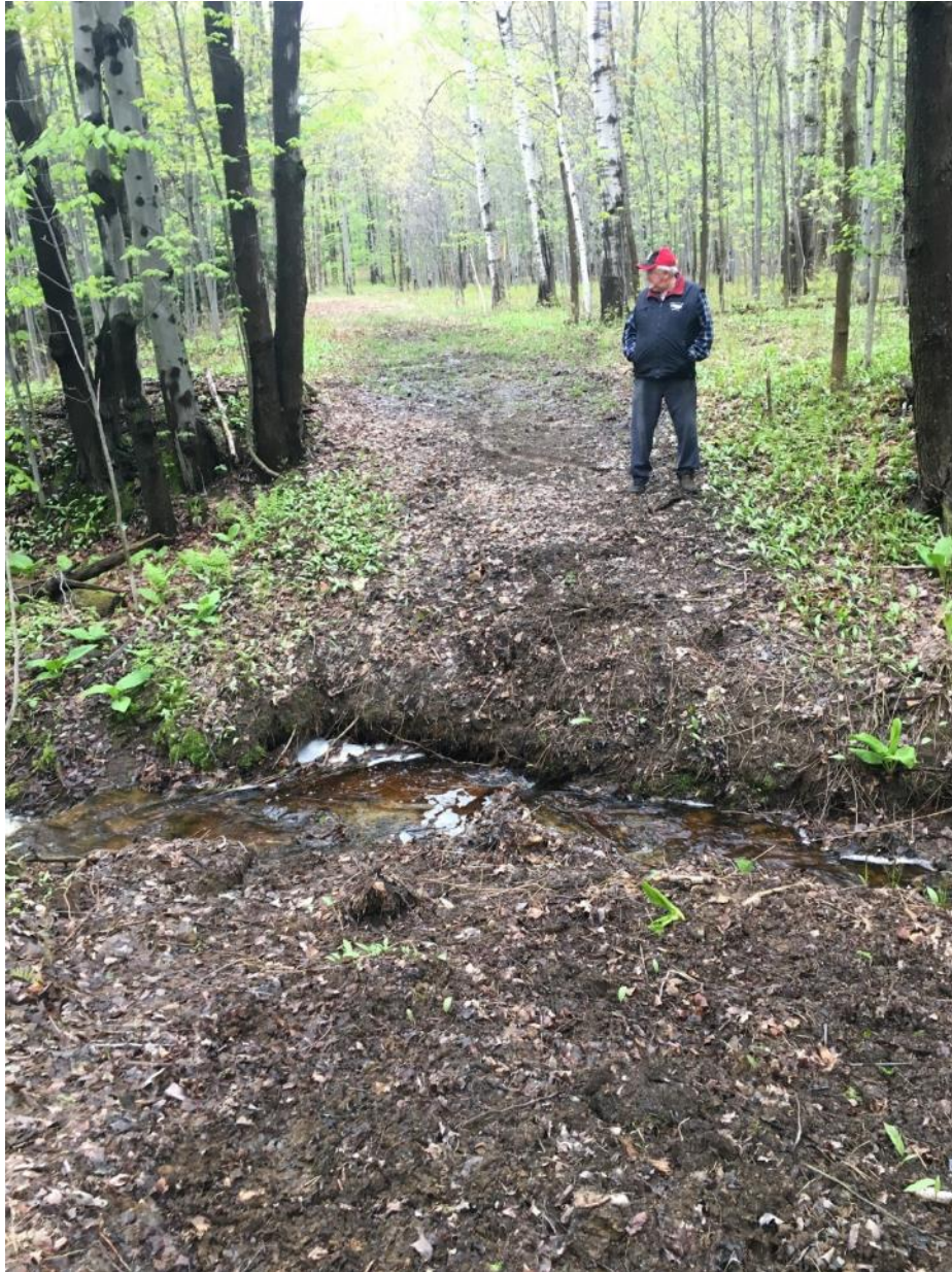
Photo du site : Ponceau circulaire avant travaux
